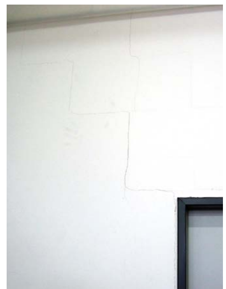
Bild 24 Rissbildung in nicht tragender Trennwand infolge Durchbiegung der unteren Geschossdecke
