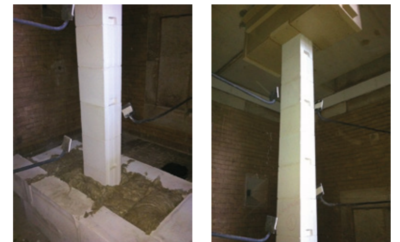
Kalksandstein-Pfeiler vor der Prüfung im Brandraum am Wandfuß (Bild links) und Wandkopf (Bild rechts).
