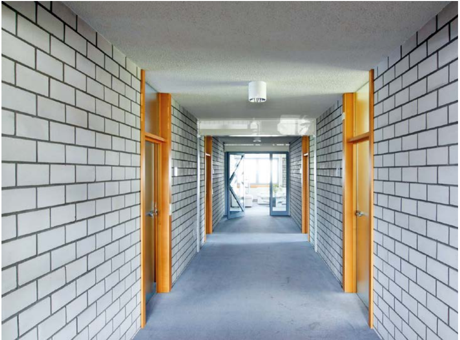
Bild 51 Im obersten Geschoss ist zu empfehlen, sehr lange tragende Wände vereinzelt durch geschosshohe Türöffnungen zu unterbrechen. Dies gilt besonders unter der Dachdecke.
