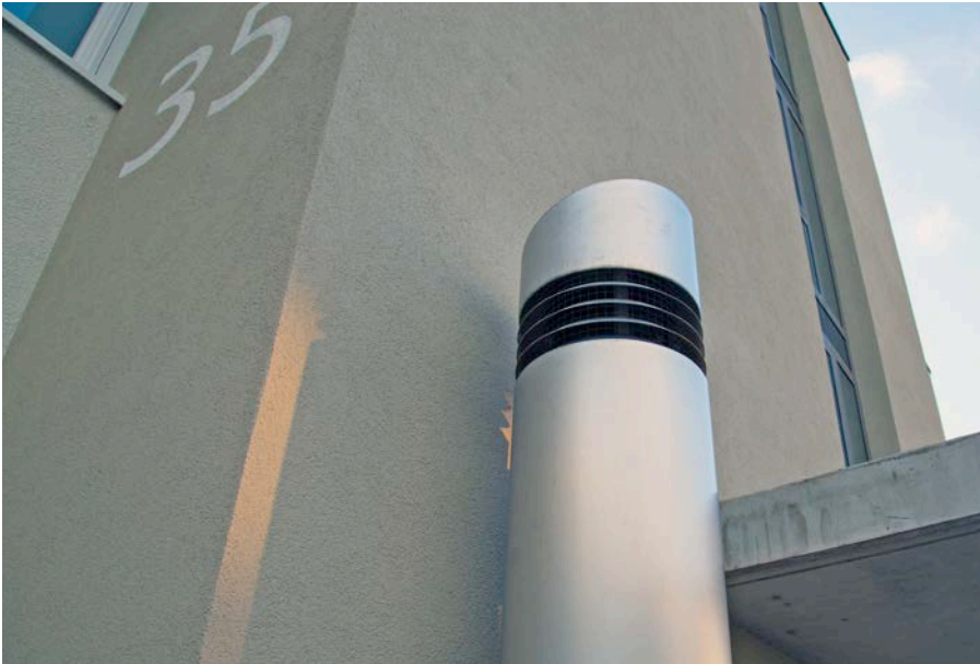
Detail: Zuluft der kontrollierten Wohnraumlüftung
