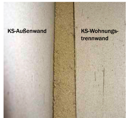
Abb. 7: Stumpfstoß zwischen Außenwand und Wohnungstrennwand mit beidseitig gelöster Mörtelfuge [25]
