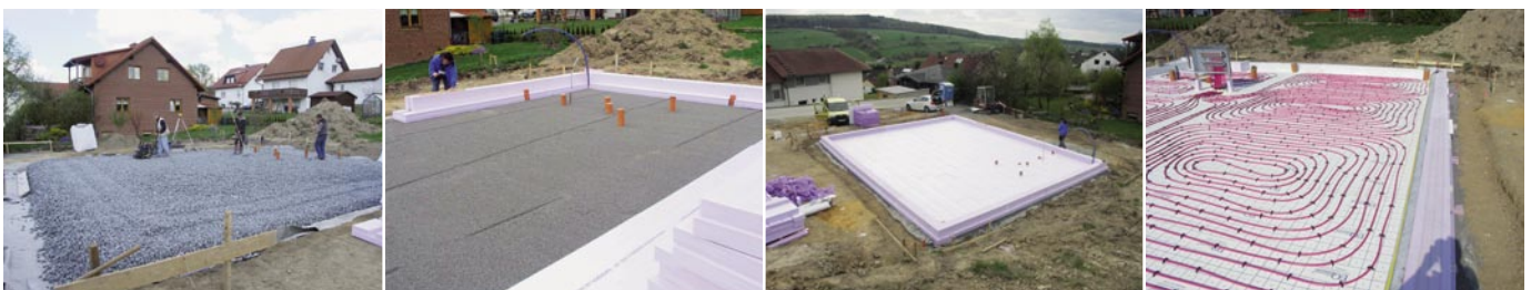
Erstellung der Bodenplatte in Körle: Erste Schicht mit Blähglas-Granulat, darauf die XPS-Dämmung und die Stahlbetonbodenplatte mit Heizschlangen. Auf deren geglättete Oberfläche wird der Oberbodenbelag direkt verlegt.
