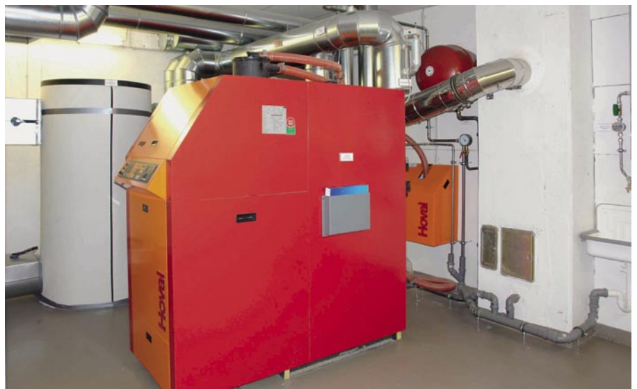
Pelletskessel in der Technikzentrale
